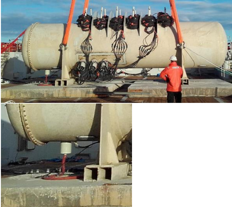
Figur 6: Ställverket vid installation med en del kablage på toppen(1kV) och utgående 12kV kabel i botten.
