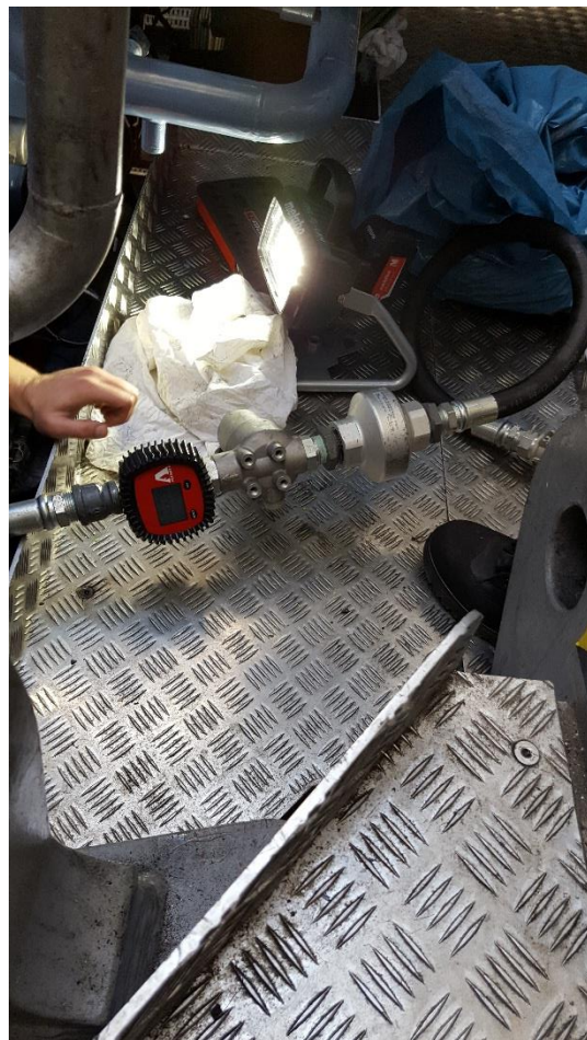
Debiet meter vulleiding
