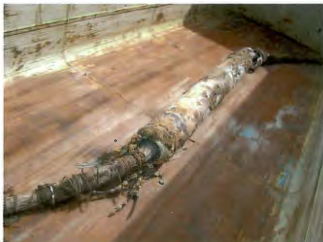
Foto 7: Versterker (repeater) UKNL-11 kabel
