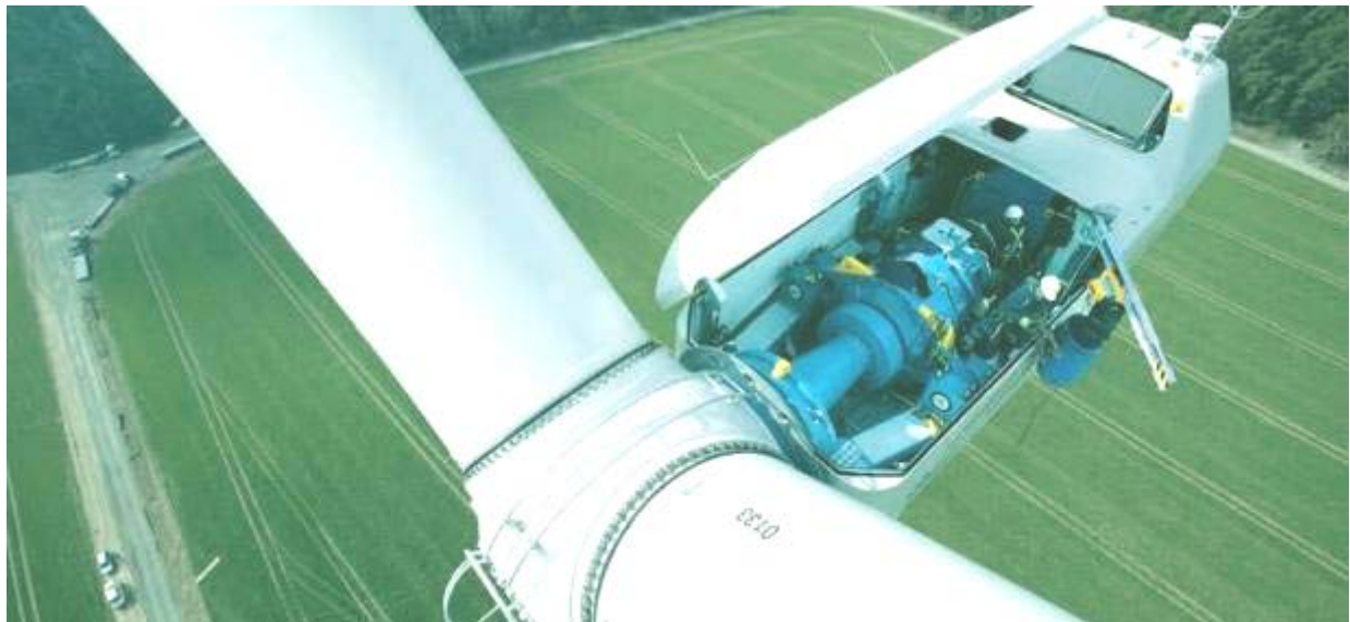
Fotografía 2-1 Instalaciones internas de un Aerogenerador Nordex*
